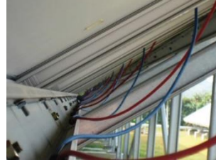
d.a. ark potansiyeli olan kötü tesisat uygulaması
