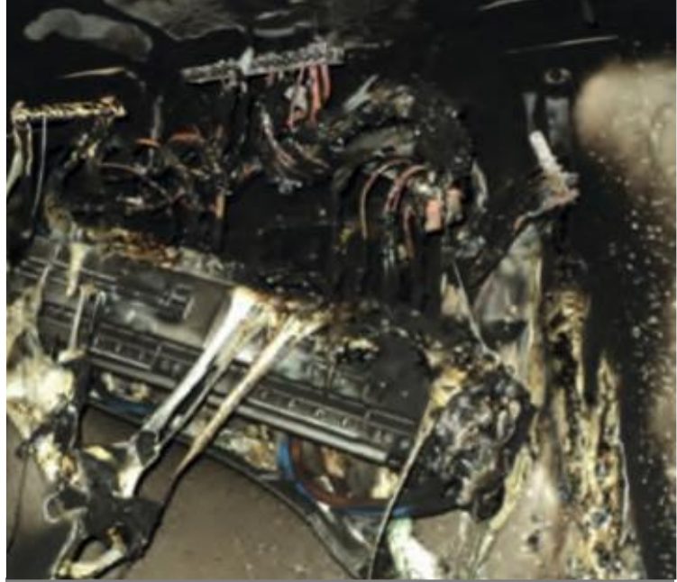
Şekil 1. Plastik dağıtım panosundaki nötr terminalinin gevşek bağlantısından kaynaklı yangın
